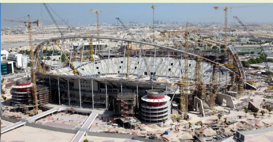
Het Khalifa-stadion zal in januari 2017 af zijn en wordt gebouwd door het Belgische bedrijf Sixconstruct (Besix). 'Besix is een van de beste leerlingen van de klas', zegt Patrick.
